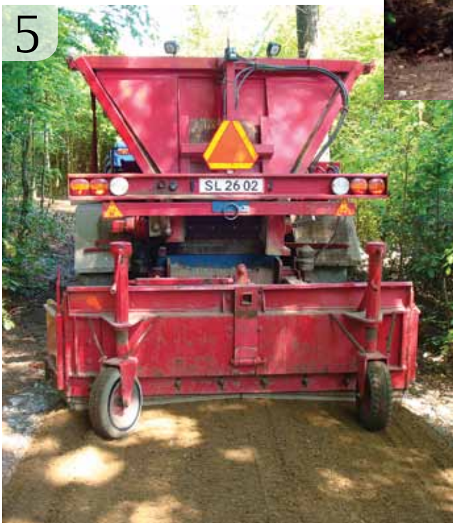
Stabilgrus udlægges med en specialudlægger. Den lægger gruset meget fint og jævnt ud og samtidig sørger den for, at profilen bliver korrekt.
