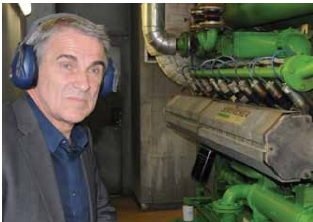
Formanden for Folketingets Energiudvalg Steen Gade besigtiger en af de to gasdrevne elmotorer på Harbøre Varmeværk. Foto: Per Hilbert
