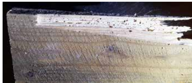
Borebiller: Træværket i fugtige huse bliver ofte angrebet af borebiller. Bemærk, at billerne kun lever i det lyse splintved, men ikke i den mørkere kerne.
