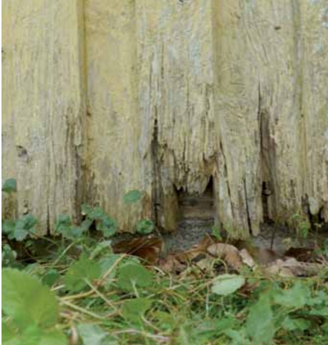
Træbeklædningen er nedbrudt, fordi afstanden til jorden er for lille.
