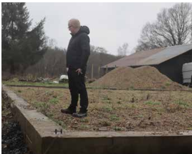
Maskinhuset brændte ned til grunden, og der er nu kun fundamentet tilbage. Det nye maskinhus ønskes opført på samme sokkel.
